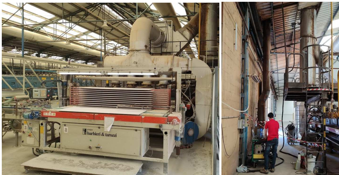
Figura 26.. Entrada del horno 1 de la planta de pavimento de Keraben (izquierda) e instalación del demostrador industrial en la chimenea de humos (derecha)
