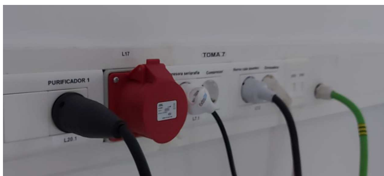
Figura 9. Ejemplo de etiquetado de tomas eléctricas. Fuente: ITE.
